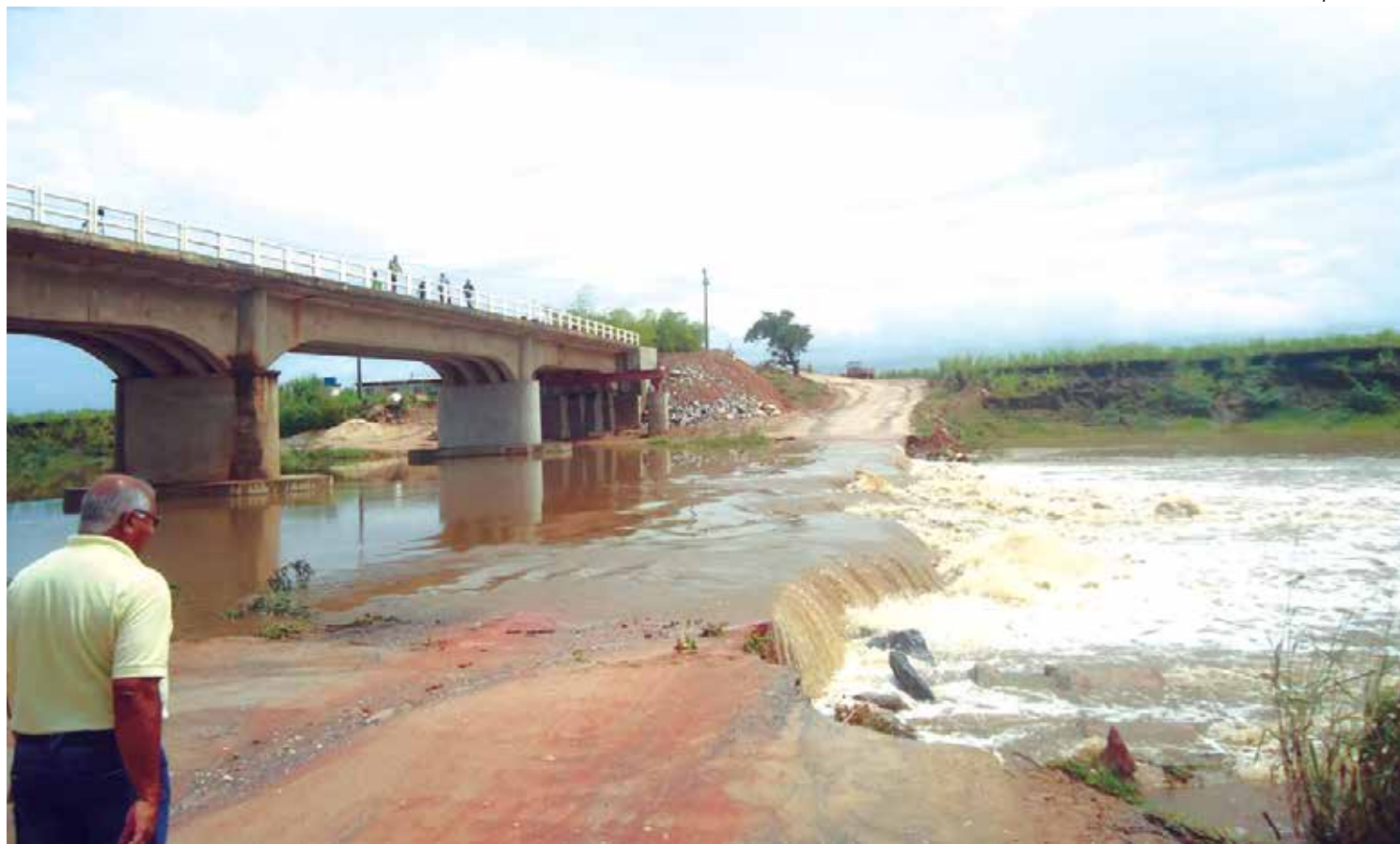
A decisão foi motivada pelo aumento das águas do Rio Paraíba por conta da chuva, que danificou o desvio construído para o tráfego
